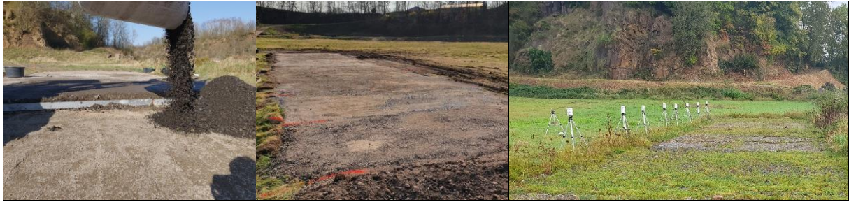
Bild 2: Befüllung der Versuchsflächen mit Vegetationssubstraten (links); fertiggestellte Versuchsflächen (Mitte); Begrünte Versuchsflächen (rechts)
